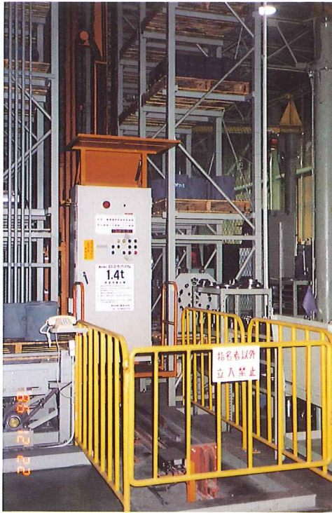
図6 スタッククレーン
